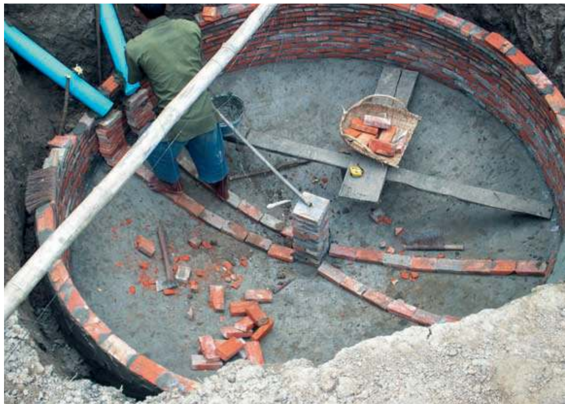
Verlegen der PVC-Rohre: das eine zur Einleitung des Dungs, das andere für die Fäkalien aus der Toilette.
