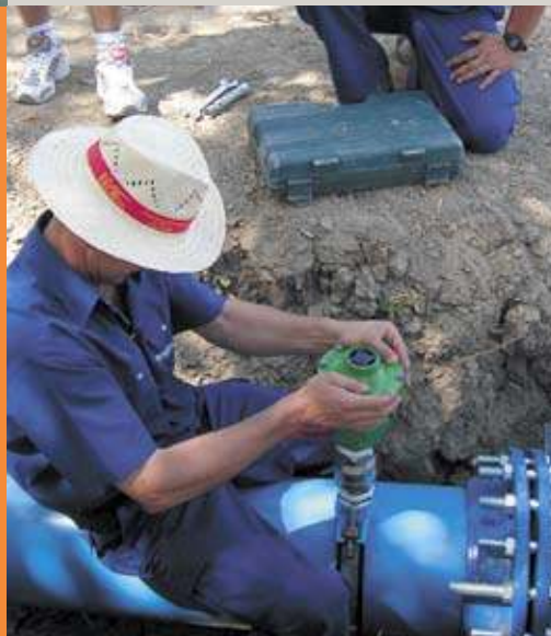
Installateur beim Anbringen eines Entlüftungsventils: Mit diesem wird die Luft aus dem PVC-Rohr abgelassen, um dann einen Drucktest durchführen zu können.
